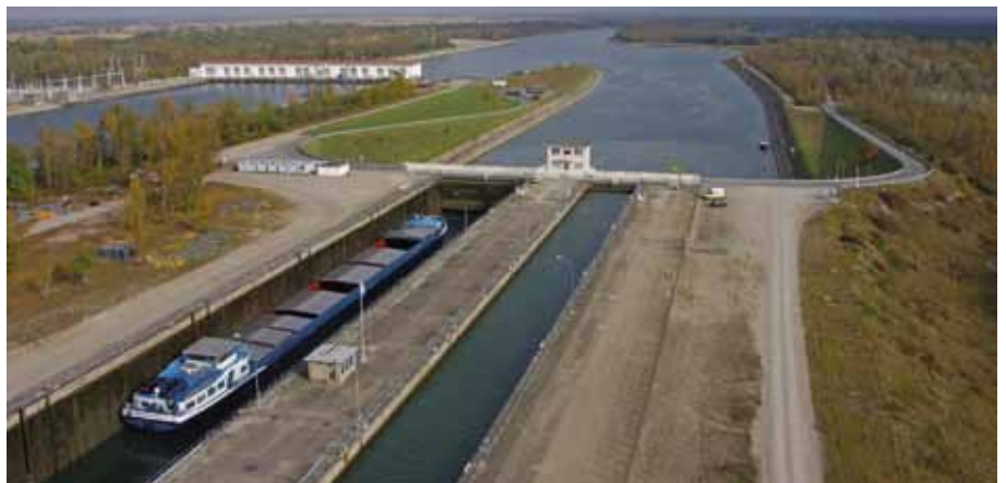
Kleine Schleusenammer von Fessenheim – April bis Anfang September 2013. 1,2 Mio. Euro. Farb-anstrich des Obertores (Asbestsanierung, Metallisierung, Farb-anstrich), Ersetzung der Abdichtung des Obertores, Modernisierung des Bedienmechanismus des Untertores, Renovierung der Betätigungsmechanismen des Untertores und Installation eines Schutzsystems, Verbesserung des Schließsystems der Tore, Betonbau
