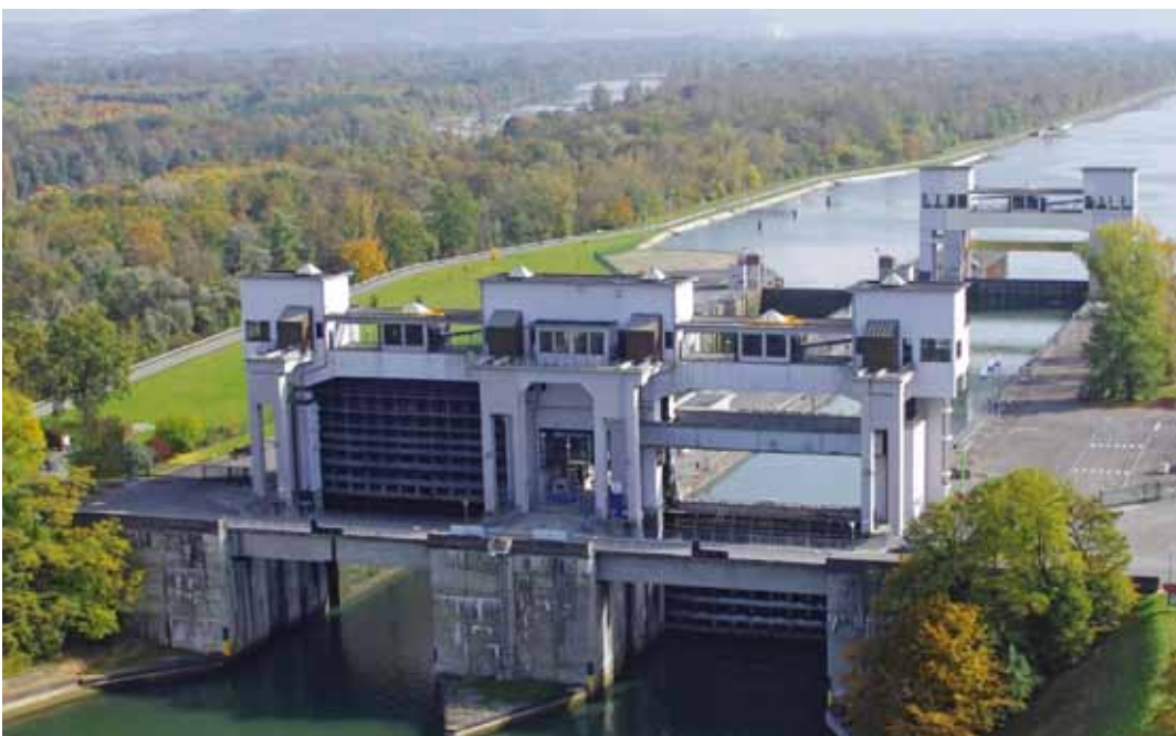
Westliche Schleusenammer von Kembs. März 2013 bis April 2014. 8,2 Mio. Euro. Ersetzen des Untertores, Farbanstrich des Obertores, Modernisierung des Leitsystems (Automatismen), Wartungsarbeiten an den Entleerungs- und Füllschützen der Schleusenammern
