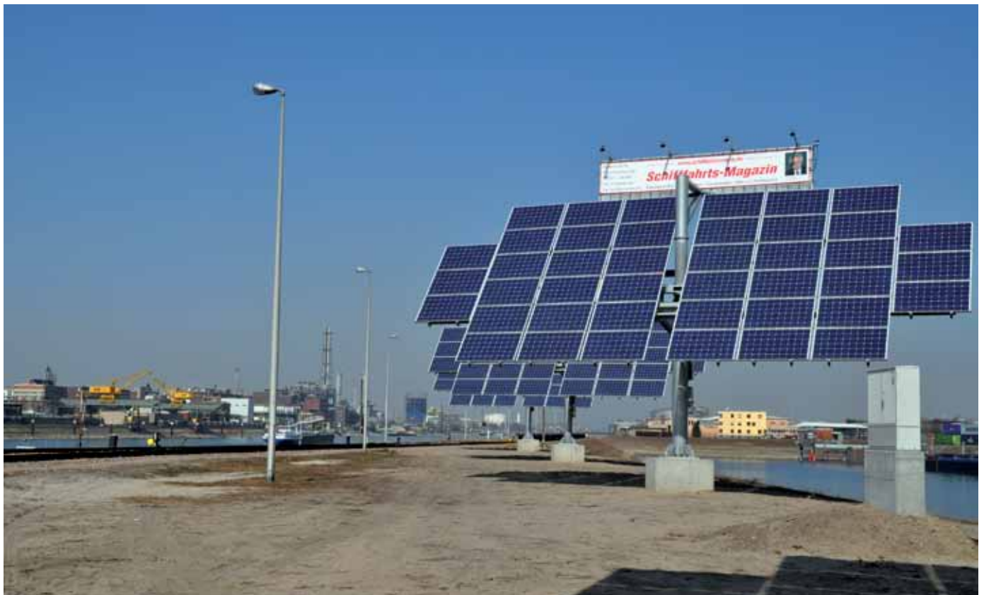
Auf der Photovoltaik-Anlage des Mannheimer Hafens - gelegen auf der Landzunge zwischen dem Rhein (links) und dem Mühlauhafen wirbt jetzt der Düsseldorfer F. Barg Verlag für die Fachzeitschrift Schiffahrts-Magazin . Den Mannheimer Hafen laufen jährlich über 8.000 Schiffe an. Die Stelle, an der die Photovoltaik-Anlage steht, wird im Jahr von über 12.000 Tank-, Fracht- und Flusskreuzfahrtschiffen passiert.
