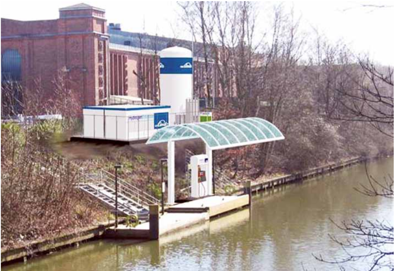
Die Wasserstofftankstelle an der Hellbrookstraße in Hamburg
