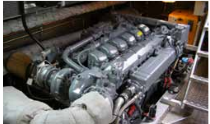
Der Steuerborddiesel MAN Typ D 2876, Leistung 360 kW (= 490 PS) des Polizeistreifenbootes 3.
