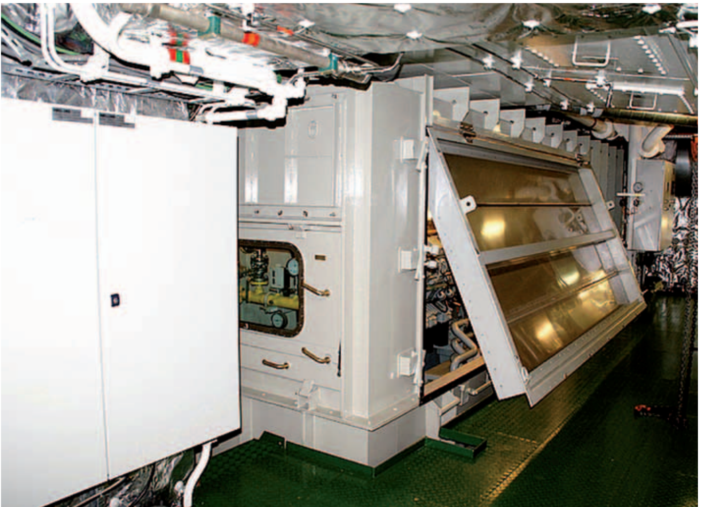
Das LNG-Kraftwerk auf der Motorfähre Moldefjord
