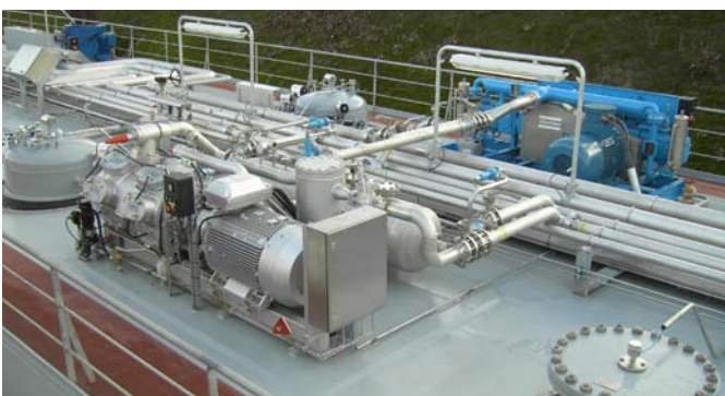
Abb. 5: Kompressoren auf Ladedeck
