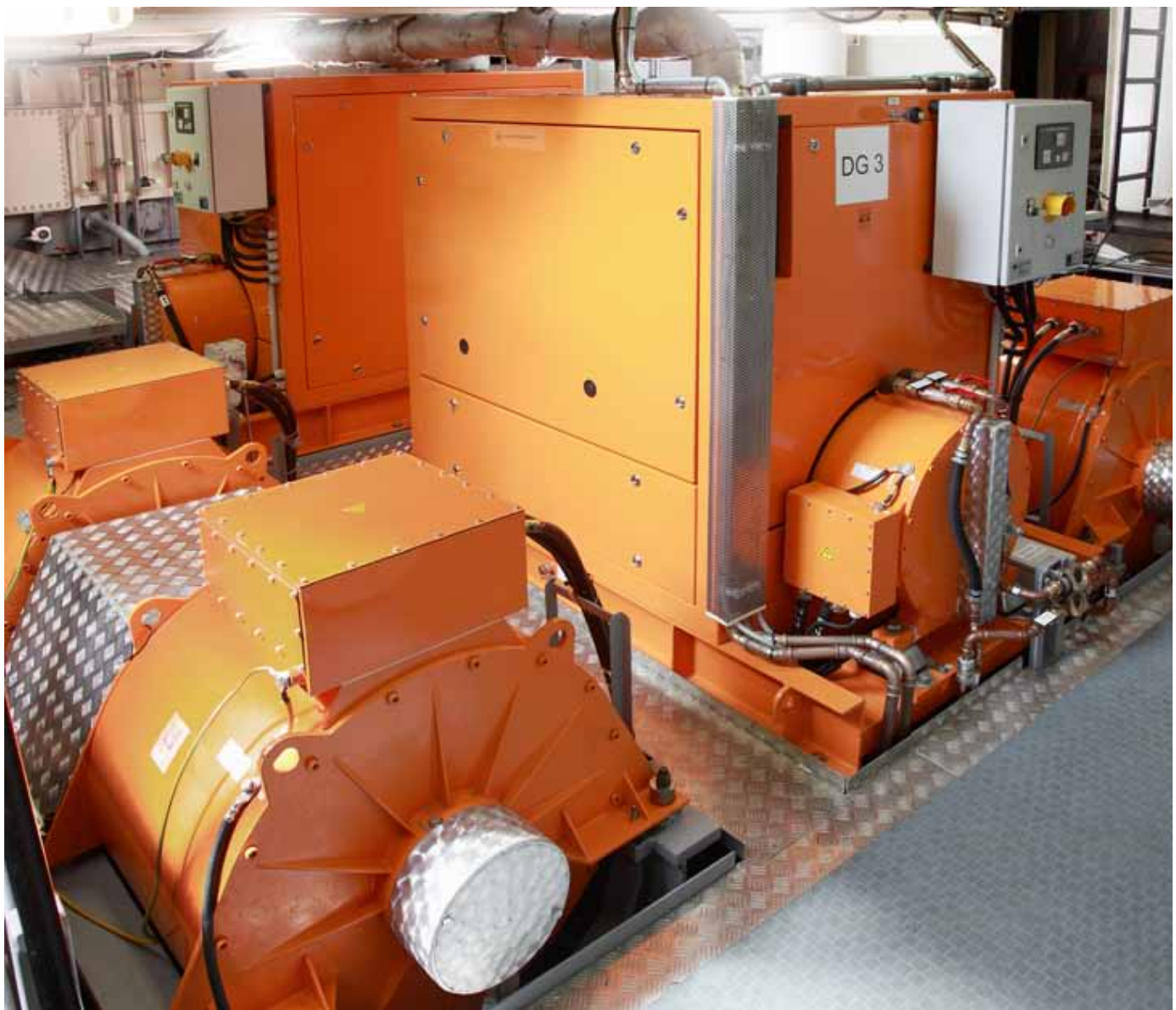
Im Maschinenraum der MS „Enok“
