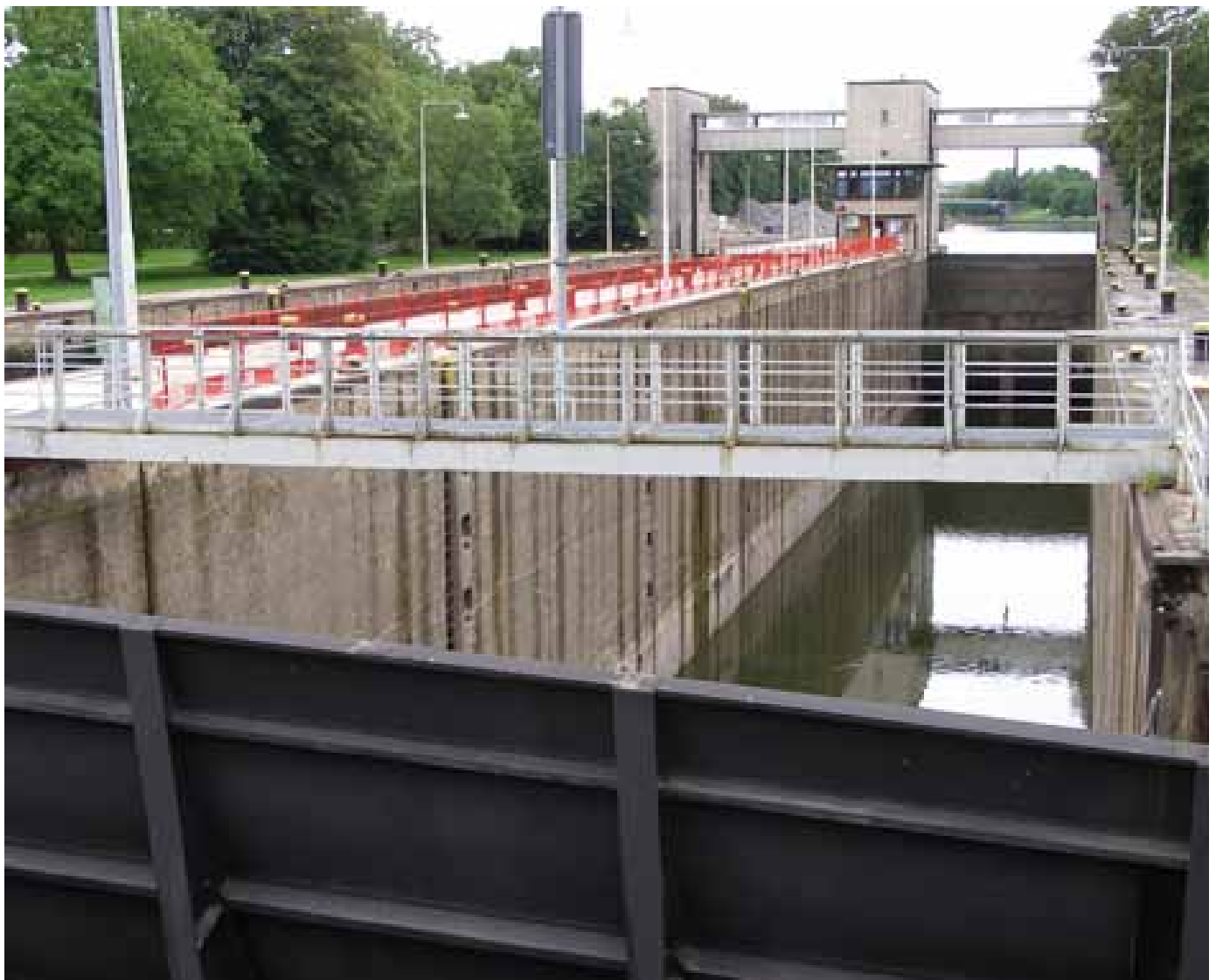
Beschädigtes Untertor der linken Schleusenammer Pleidelsheim
